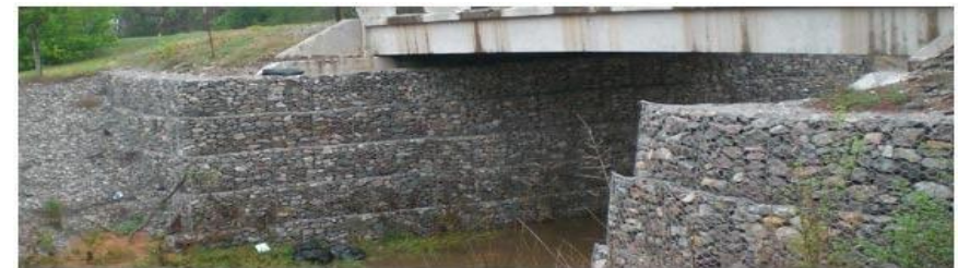
ตัวอย่างระบบป้องกันการกัดเซาะตลิ่ง โดยวิธี Rock Gabion
